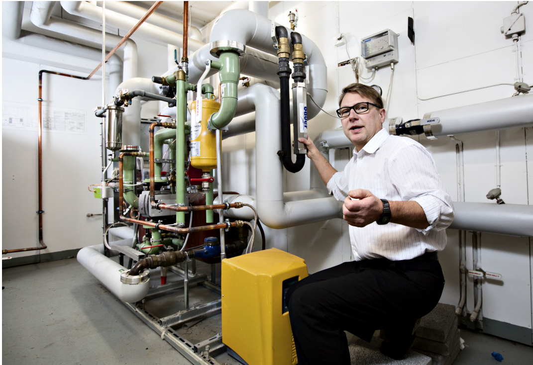
ESPOON LAURINLAHTI. Veikko Timosen yritys on asentanut putkien saostumista estävän vedenkäsittelylaitteen yli 6 000 kerrostaloon. Espoolaisen kerrostalon lämmitysjärjestelmään laite on asennettu vuosi sitten. Käyttövedellä oma laite, mutta se ei näy kuvassa.
