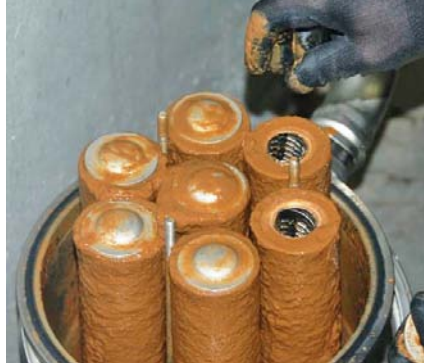
Bis zum ersten Filterwechsel wurden bereits größere Mengen zuvor in den verschiedenen Anlagenteilen festsitzende Verschmutzungen gelöst.
