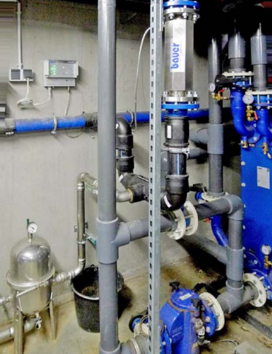
Einfacher Aufbau: Der in den Kühlwasserkreislauf integrierte Spulenkörper erhält die Signale von der Steuerung (im Hintergrund). Der Filter (links unten) arbeitet mit Wechselkartuschen.
