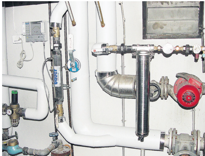
Bauer-vedenkäsittelyjärjestelmä asennettuna lämmitysjärjestelmään.
