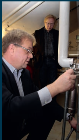
Tuotepäällikkö Mikko Timonen tarkistaa tottuneesti suodattimen viitasaarelaisen vuokratalon laitehuoneessa.
