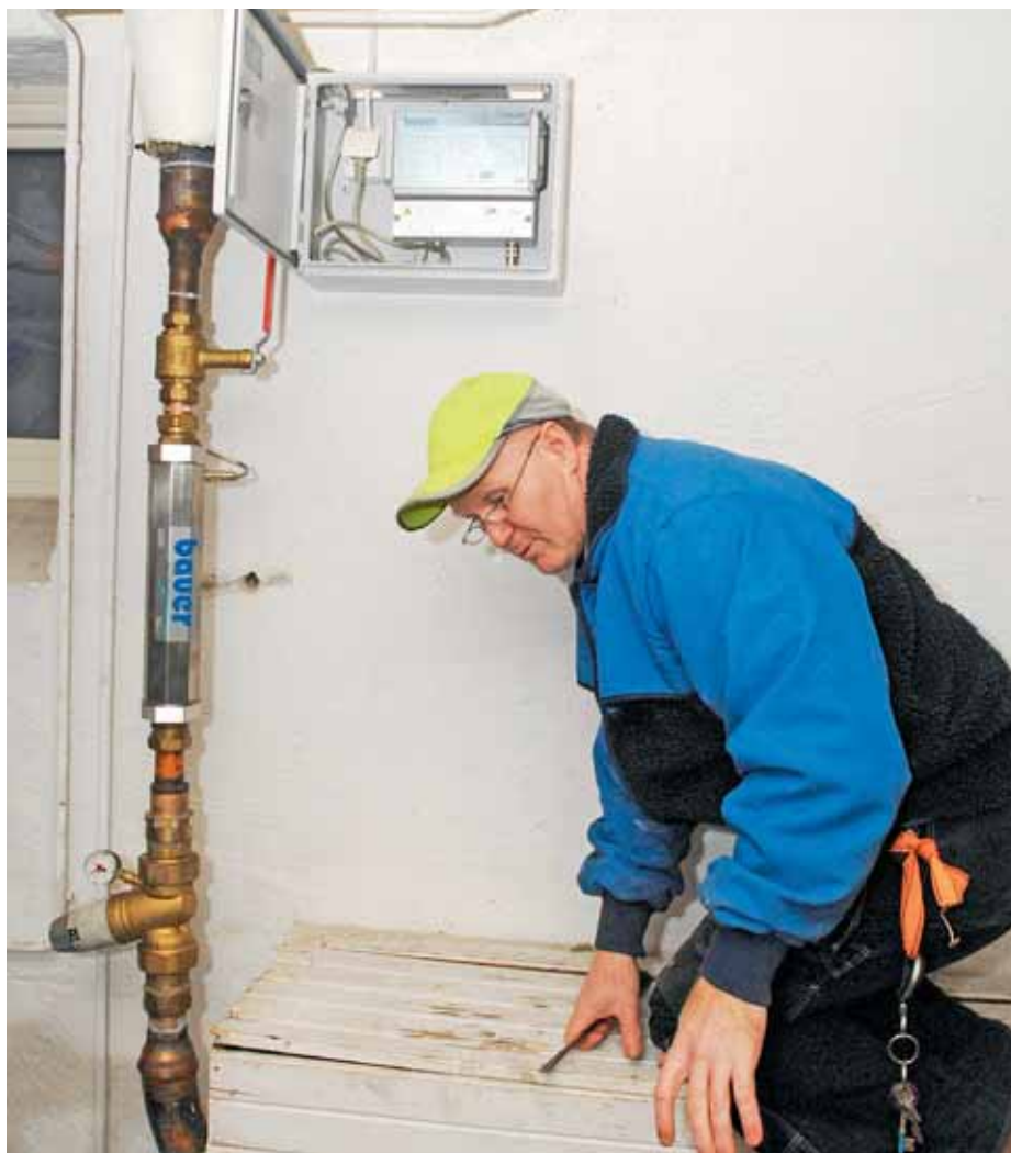
För att komma till rätta med ständigt återkommande vattenskadorna har man i Mölndal installerat reduceringsventiler tillsammans med vattenreningen. Trycket reduceras från cirka 7–8 bar till cirka 4–5 bar.
